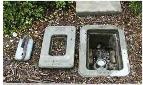
Figura 5-7: Medidor de agua
